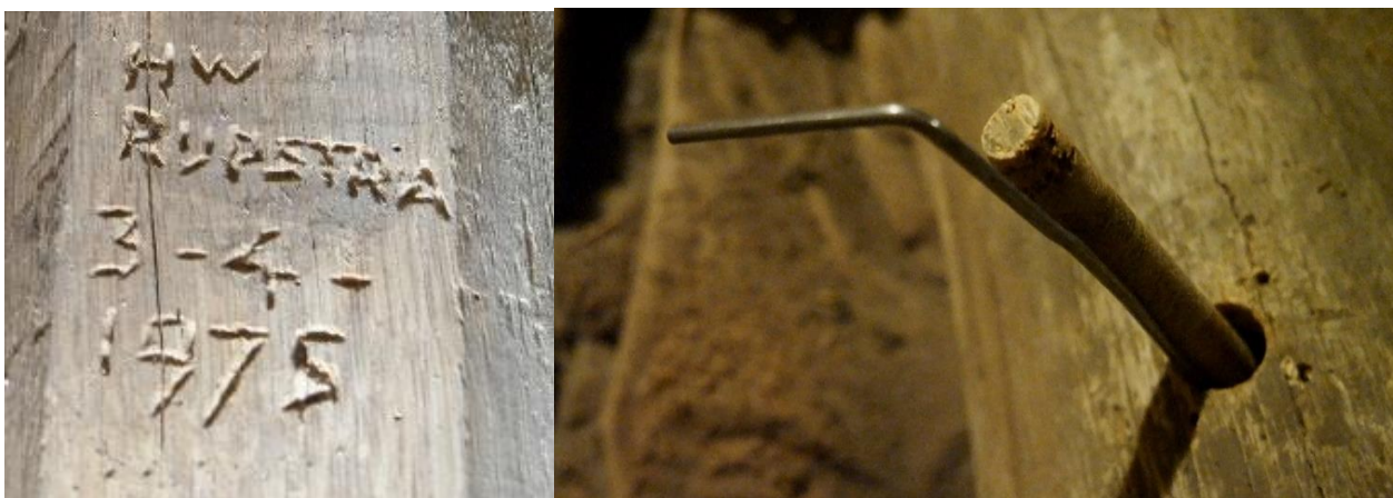
Op de koningsvink in het centrum van de constructie boven het koor staat H.W. Rijpstra 3-4-1975 gebeiteld. Deze koningsvink is een jonge reparatie. Op de rechter foto is te zien hoe een boorstaal uit het hout tevoorschijn komt. Aan het hout is te zien dat de belangrijke spintlaag er nog aan zit.
